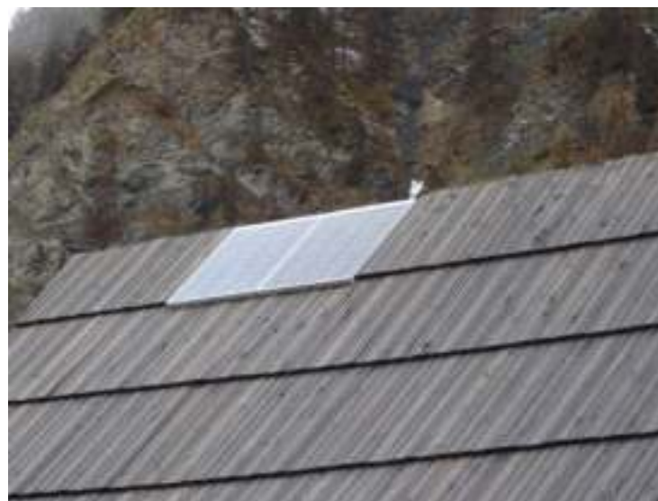
PANNEAU SOLAIRE THERMIQUE TOITURE EN BARDEAU
