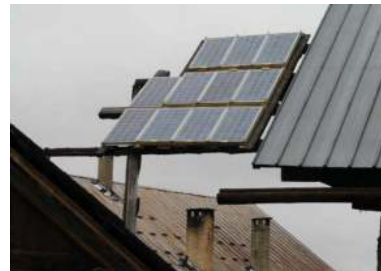
INSTALLATION DE PANNEAUX À AMÉLIORER
