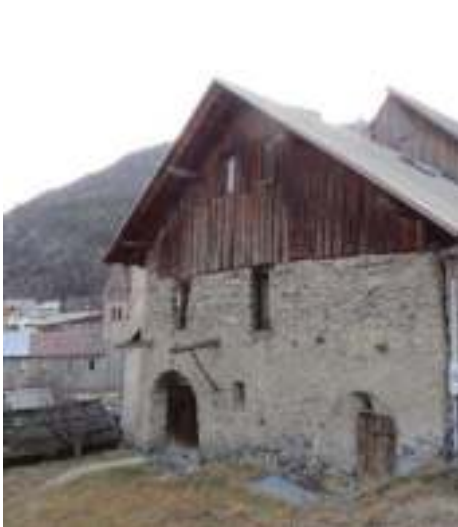
PAREMENT MIXTE ET DÉBORD DU BARDAGE INSUFFISANT
